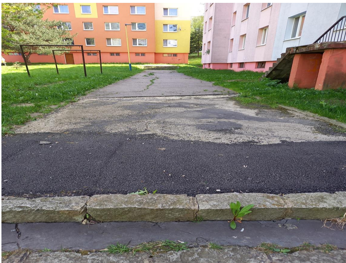
Ul. Bratislavská vnútrob. medzi ul. L. Novomestského č. 6 a Bratislavská č. 2 – oprava chodníka na ploche 238 m 2 v predpokladanej cene: 35 955 €
