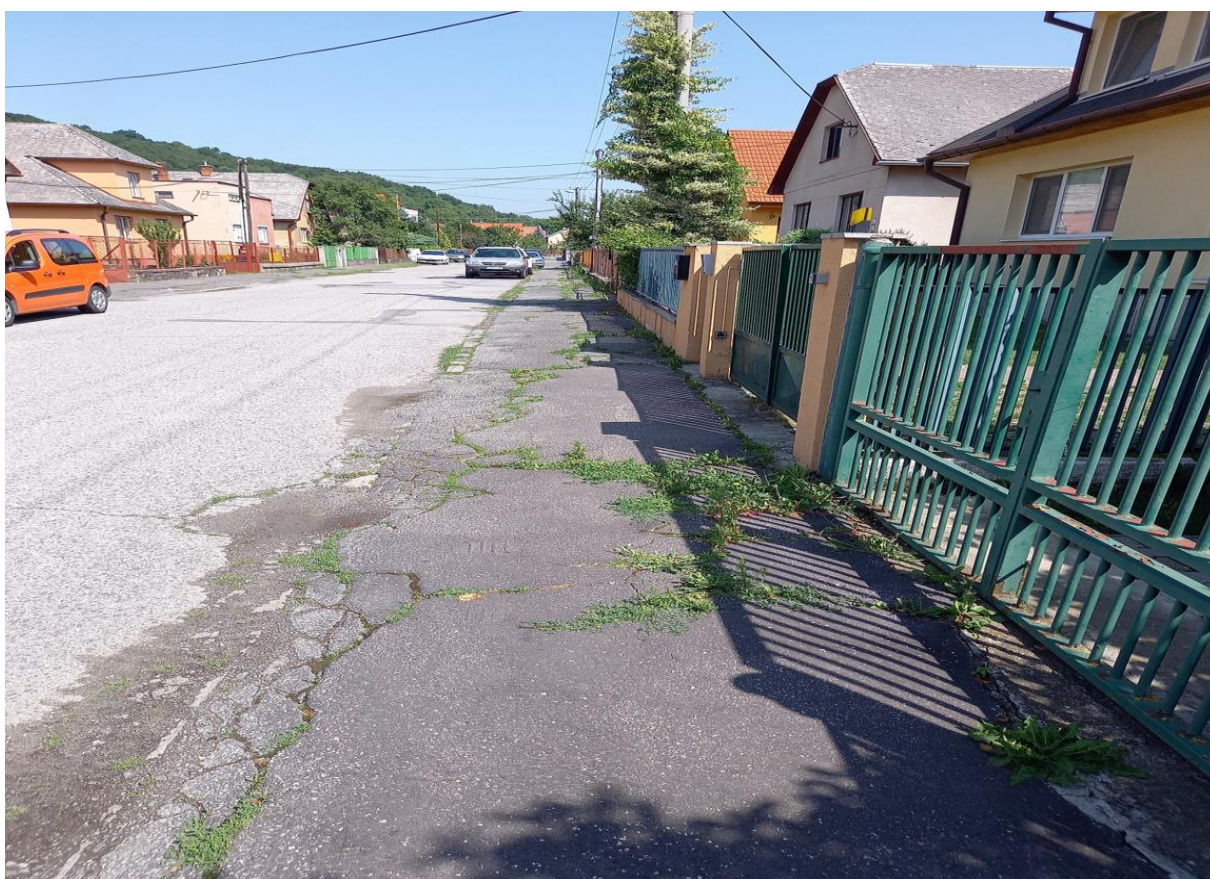
Ul. Petöfiho č. 2 až 38 – oprava chodníka na ploche 780 m 2 v predpokladanej cene: 85 188 €
