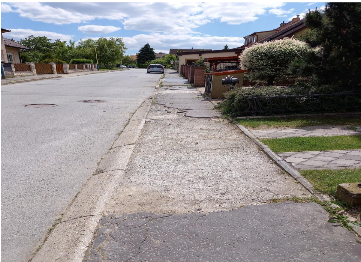
Ul. Švábska č. 47 až 51 – oprava chodníka na ploche 315 m 2 v predpokladanej cene: 25 545 €
