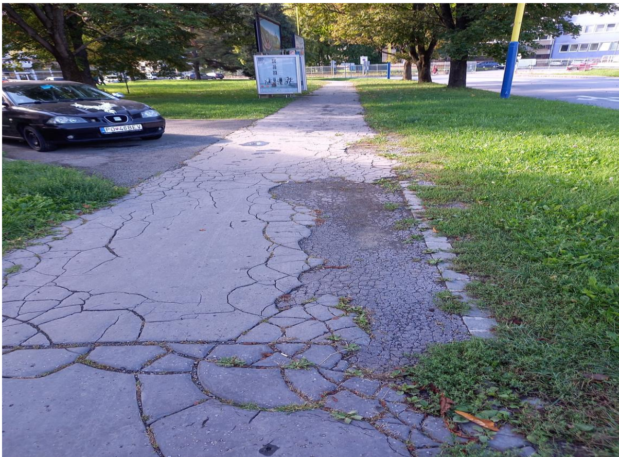
Ul. Zimný potok č. 1 až 59 – oprava cesty bez odvodnenia na ploche 2632 m 2 v predpokladanej cene: 267 338 €
