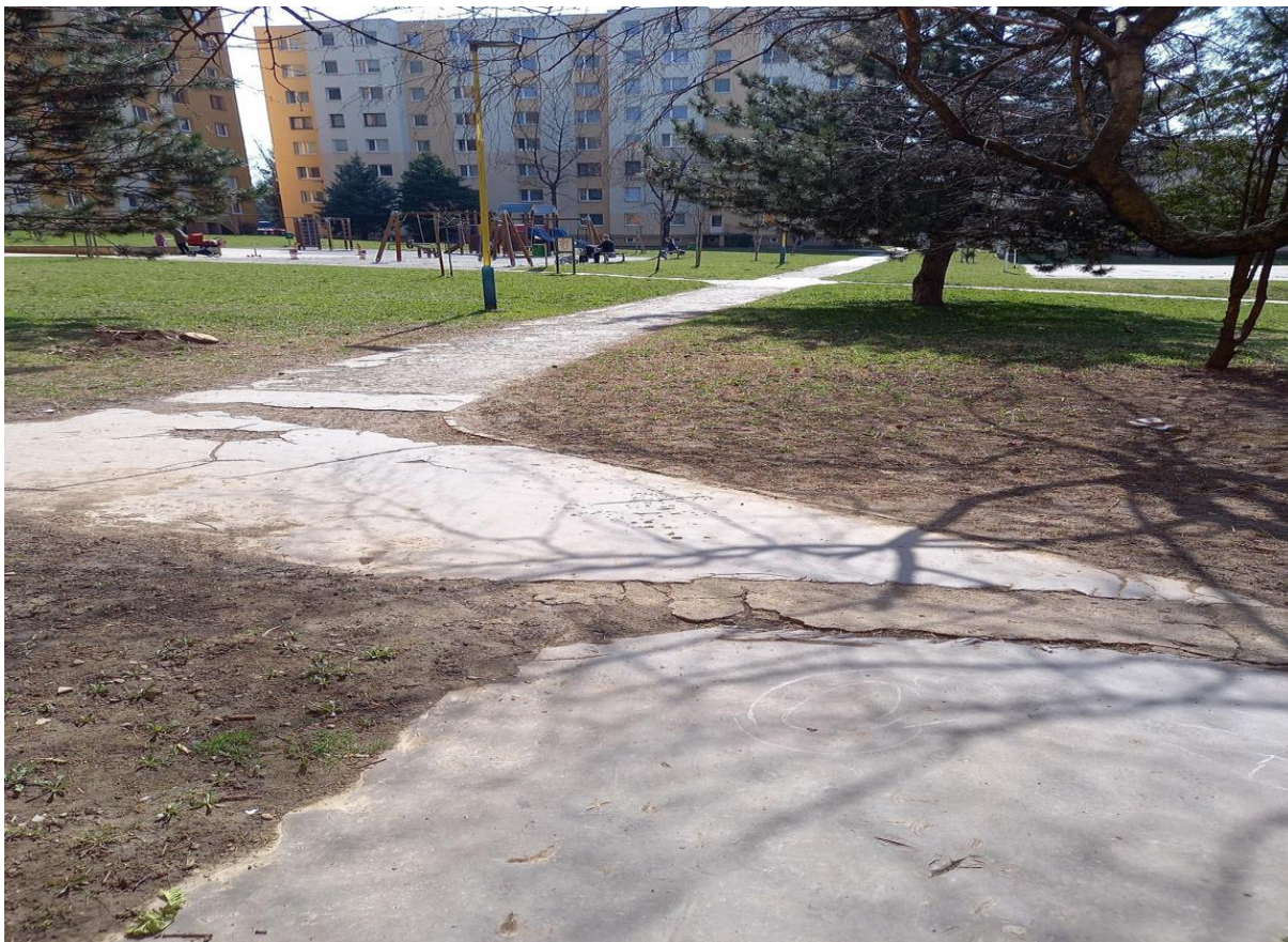
Ul. Bratislavská č. 2 – oprava schodov na ploche 5 m 2 v predpokladanej cene: 550 €
