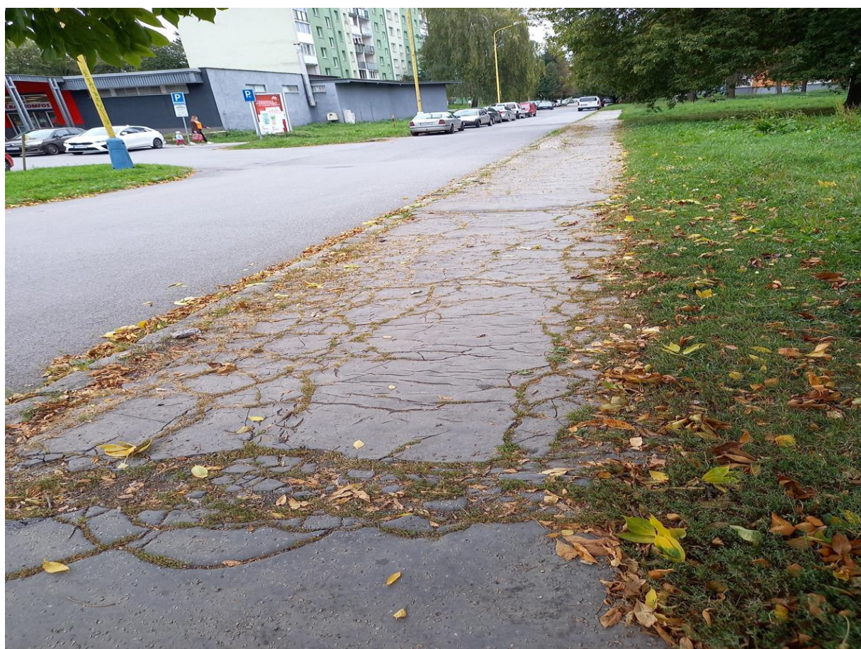
Ul. Nám. Kráľovnej pokoja - od M. Slovenskej k Družbe – oprava chodníka na ploche 1854 m 2 v predpokladanej cene: 153 318 €
