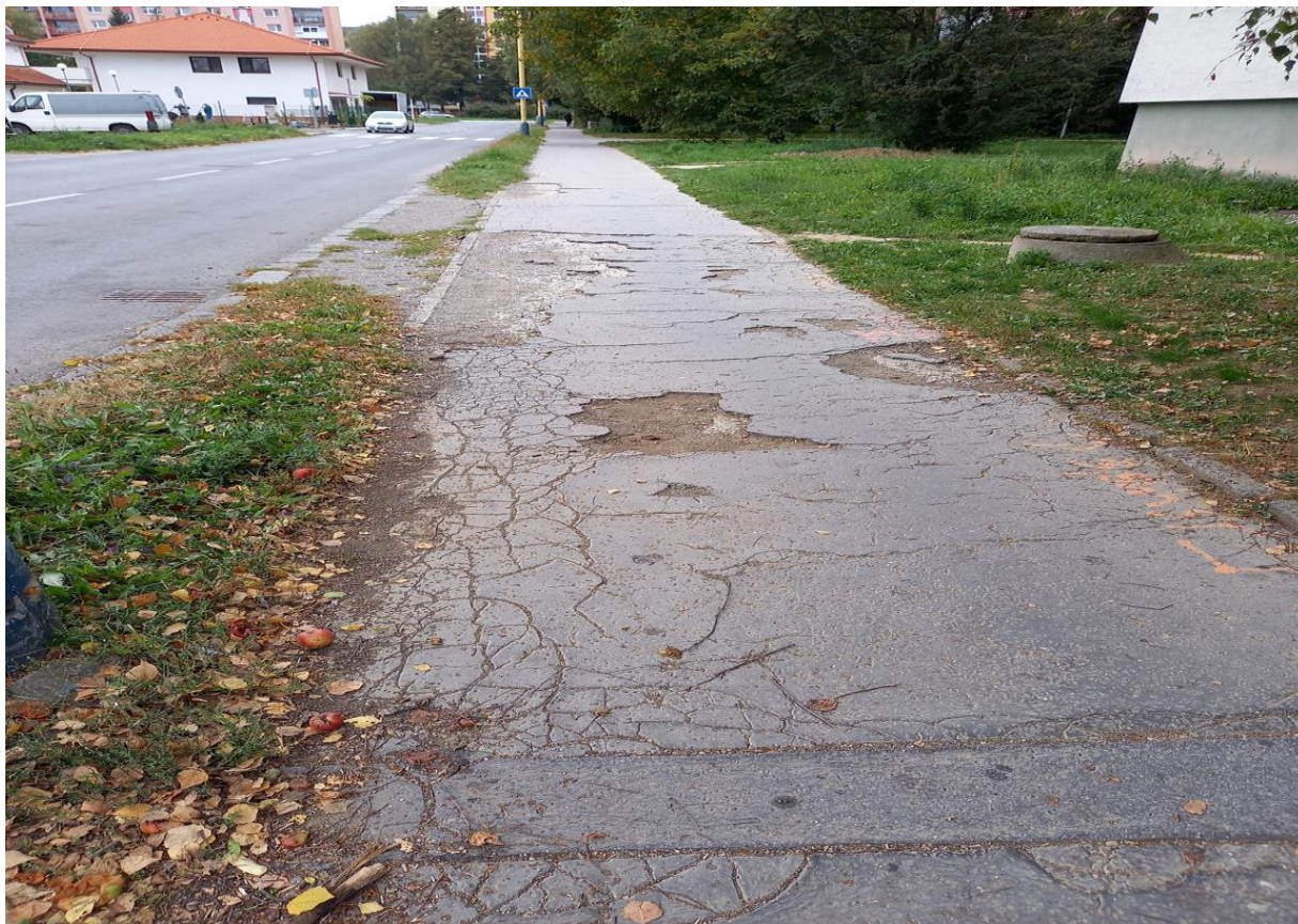
Ul. Bajkalská - oproti predajni CBA – oprava chodníka na ploche 182 m 2 v predpoklad. cene: 19 277 €
