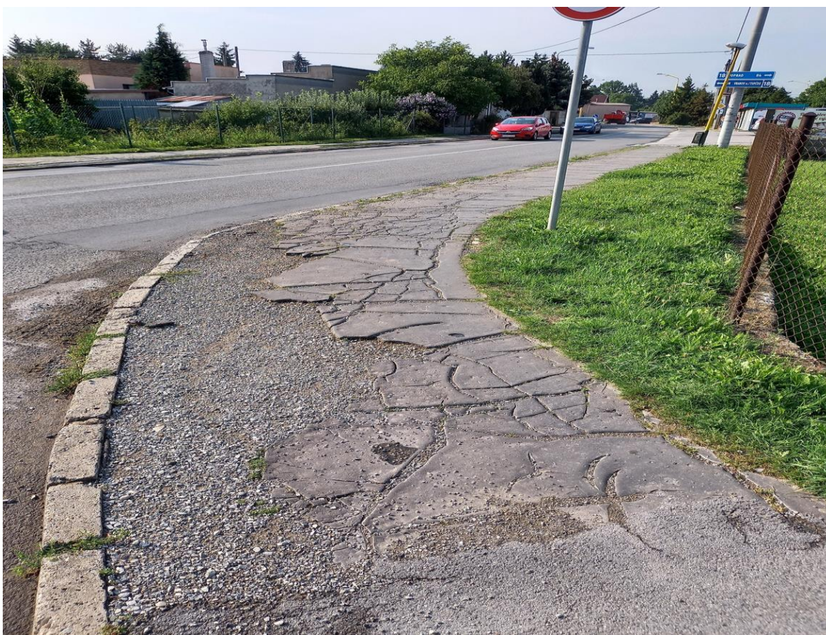
Ul. Jánošíkova č. 74 / 18A – oprava cesty na ploche 363 m 2 v predpokladanej cene: 36 284 €
